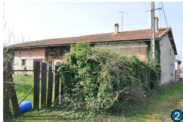
Vue sur la face nord de l'îlot depuis la Rue Haute. Ce bâtiment en état dégradé a été inclus dans le périmètre de l'OAP pour anticiper sa gestion.
